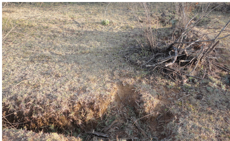
Foto 2. Talud en retroceso
